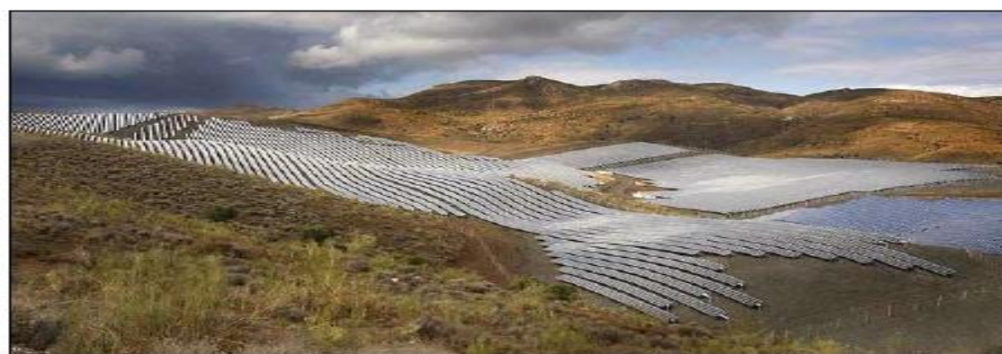
Parque solar de Lucainena de las Torres (Almería)
